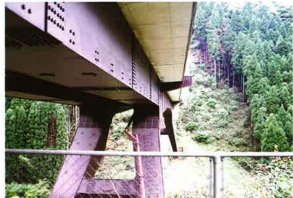
箱桁橋梁塔 (7年後)
