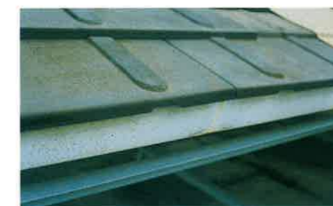
実物件屋根材の 暴露観察材 (約20年) ラスコールN #100
